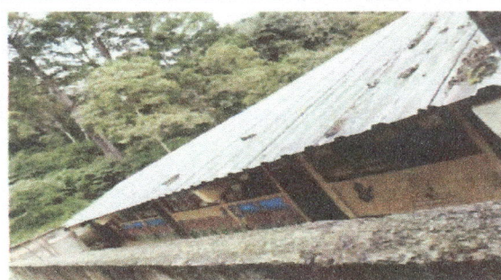
Foto 8: Fotografía en alto en donde se puede constatar la necesidad de colocación de canales y bajadas de agua pluvial frente a las aulas.
