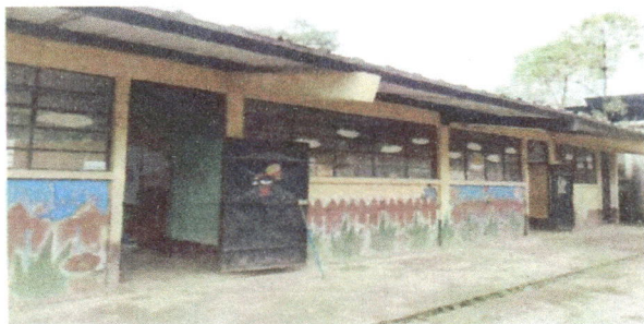
Foto 3: Vista de puertas que necesitan mantenimiento (en total 5 puertas).
