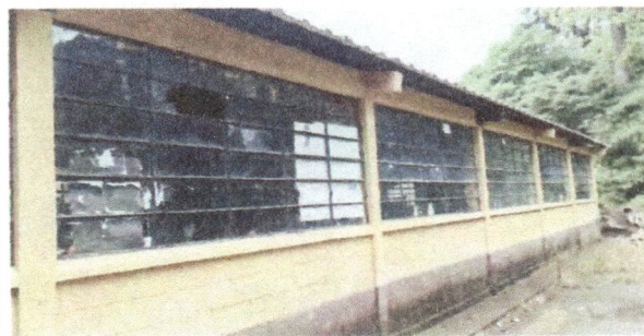
Foto 4: Imagen trasera de de aulas y direccion en donde es necesaria la colocación de balcones y asimismo la sustitución de algunos vidrios quebrados.
