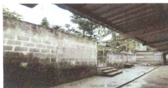
Foto 2: Vista de parte frontal de aulas en donde es necesario entechar para proteger a los niños de la interperie.
