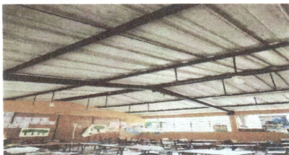
Foto1: Fotografía de aulas y direccion en donde es necesaria la reparación de sistema eléctrico.
