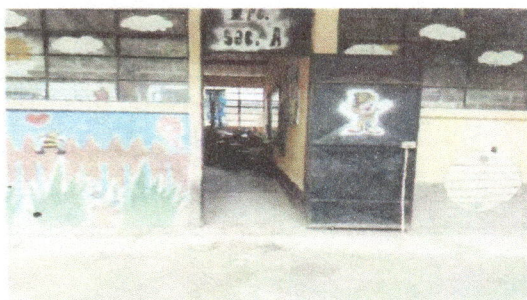
Foto 9: Imagen de paredes de establecimiento que necesitan ser aplicación de pintura.
