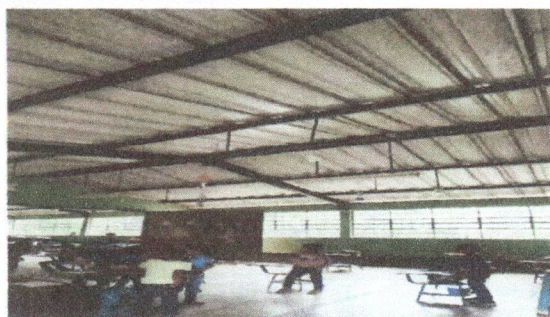
Foto 7: Vista interior de aula en donde se puede apreciar la necesidad de sustituir costaneras o estructura de techo.
